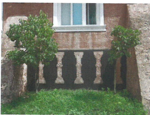
Bígr, 2014, novodobé úpravy soklů
