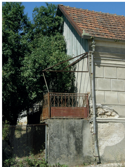
foto 2.14 Poškozený, dřevavý a promáčk- nutý svod způsobil poškození omítek fasády a soklu.
