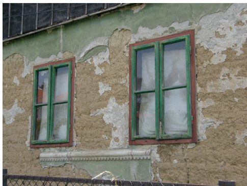
foto 2.10 Pohled na uliční fasádu domu s opadanou omítkou, obvodové odhalené zdivo je tvořeno truplovaným zdivem (hlína, jíl, větve zalívané do bednění na kamenný sokl).
