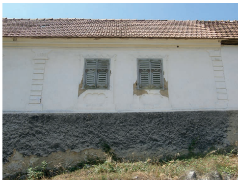
foto 2.15 Chybějící žlab způsobuje odkapávání dešťové vody ze střechy a způsobuje poškození štukové fasády kolem oken. Zavlhčený terén kolem paty domu způsobuje vnikání vody do soklu a následné odpadávání omítky.
