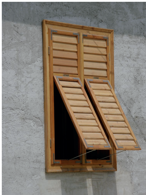
foto 5. 56 Nově osazené žaluziové okenice, které zopakovaly původní řešení okenic dokonce i s detailem kovových rohovníků v nároží dřevěných ráků. Takové řešení je pro zachování ducha domu ideální.
