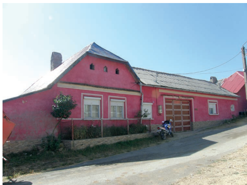
foto 3.25 Novodobá oprava fasády spočívala nejspíše v opravě omítek a v následně provedeném nátěru. Nátěr sytě červený je soudobá moderní záležitost, která se do banátských vesnic na historické objekty nehodí. Není tradiční barevností, příliš zdůrazňuje hmotu domu a příliš na sebe upoutává pozornost, což není vždy zcela žádoucí.
