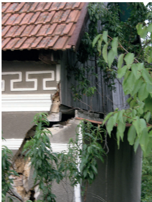
foto 2.13 Obrovská prasklina v samotné hmotě zdiva způsobila utržení nároží. Důvodem je chybějící žlab a svod, díky nimž voda dlouhodobě podmáčela nároží domu. To následně pokleslo. Zároveň voda ve zdivu několikrát zmrzla a rozmrzla, zvětšila tím svůj objem a rovněž se podílela na roztrhnutí nároží.
