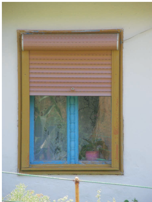
foto 5.54 Na starší dřevěné dvoukřídlové okno byla usazena novodobá svínovací roleta pro zastínění. Škoda, nejedná se o tradiční prvek, vzhledově dost poškozují celek domu.
